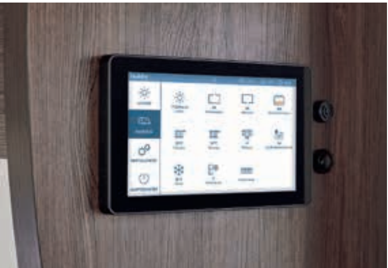
BEDIENPANEL ZUR STEUERUNG DER BORDTECHNIK
